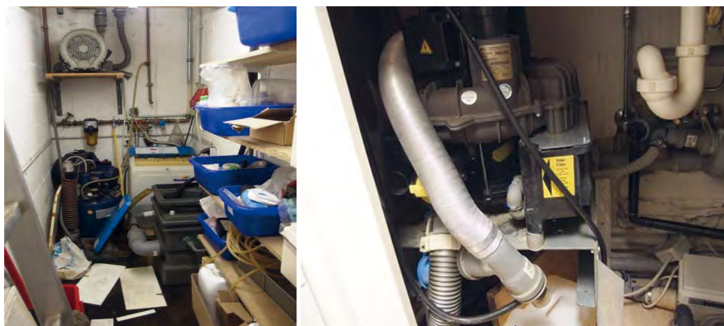
Abb. 68: Fehler bei Absauganlagen und Kompressoren in Kellerräumen von Zahnarztpraxen – in beiden Fällen wird die Luft in den Raum geleitet, im linken Raum ist Schimmelbefall erkennbar
