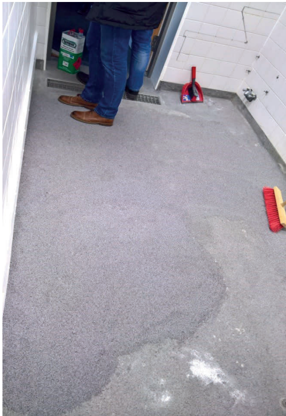
Abb. 1 Zu überarbeitender Fußboden in der Spülküche
