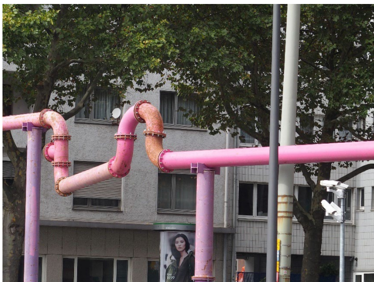
Rohre der Grundwasserhaltung
