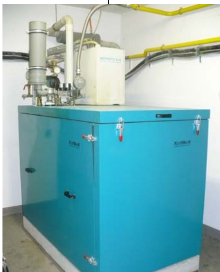
BHKW im Heizungskeller Hotel Hessischer Hof, Frankfurt
