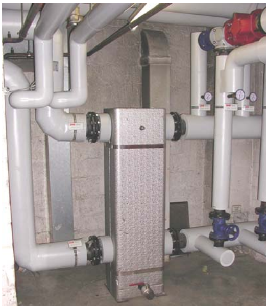
Bild4: Heizzentrale Breitlacher Straße 89 Anbindung der Heizungsanlage und der KWK-Anlage an das Nahwärmenetz
