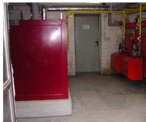
Bild 3: Heizzentrale Breitlacher Straße 89 mit Kessel- und KWK-Anlage
