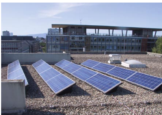
Die Solaranlage auf unserem Flachdach ist ein wichtiger Beitrag zur Ökologie
