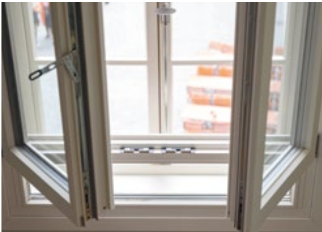
Abbildung 15: Energetische Ertüchtigung durch die Ausbildung von Kastenfenstern mit einer innenliegenden Wärmeschutzverglasung. Das bauzeitliche Fenster auf der Außenseite kann so erhalten oder nachgebildet werden. (Foto: Salome Roessler)
