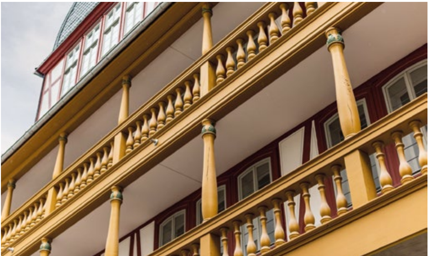
Abbildung 16: Wärmebrücke im Laubengang (Foto: Karin Gerhardt)
