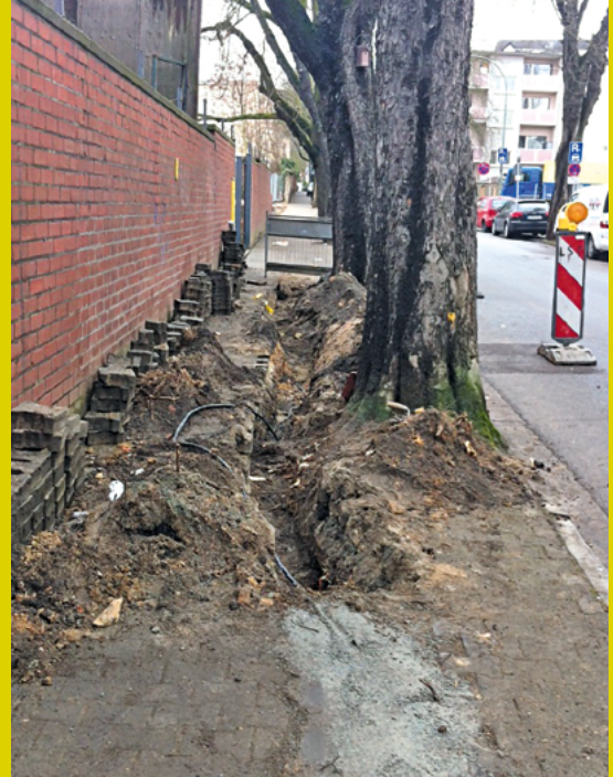
Wurzelschaden bei Leitungsarbeiten
