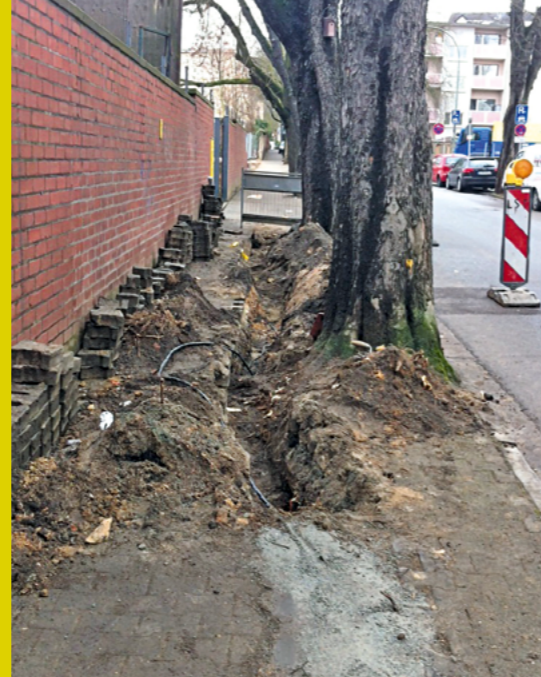
Wurzelschaden bei Leitungsarbeiten
