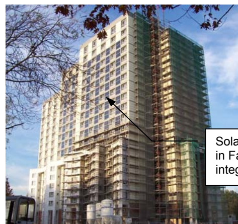
Bild-3: Gebäude nach der Sanierung mit thermischer Solaranlage in der Fassade integriert, Ausrichtung SW
