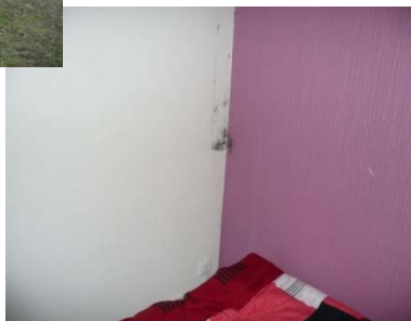
... führt auf der Innenseite zum Schimmelpilzschaden.
