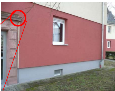
Die Wärmebrücke durch das aus der Dämmung ausgesparte Sandsteingewände ....
