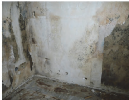
Vor der Instandsetzung ...
