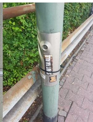
(Mastklappe wegen Kabelbinder nicht erreichbar)
