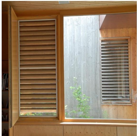
Nachtlüftungsöffnung Albert-Schweitzer-Schule, Foto: ABI, Abteilung Energiemanagement
