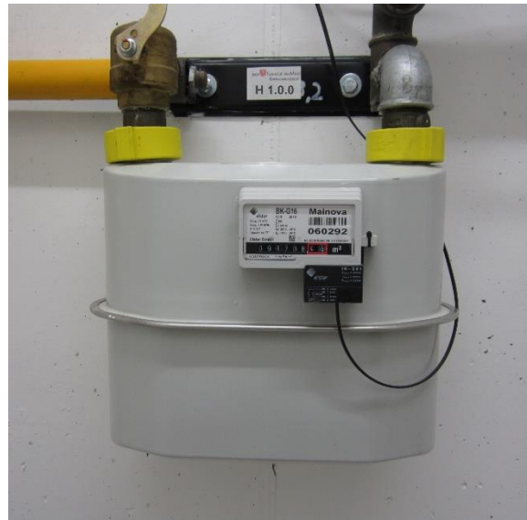
Gaszähler mit Impulsausgang
