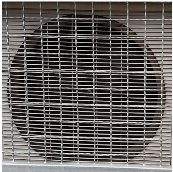
Kondensator Bürogebäude Gerbermühlstraße 48 Foto: ABI, Abteilung Energiemanagement
