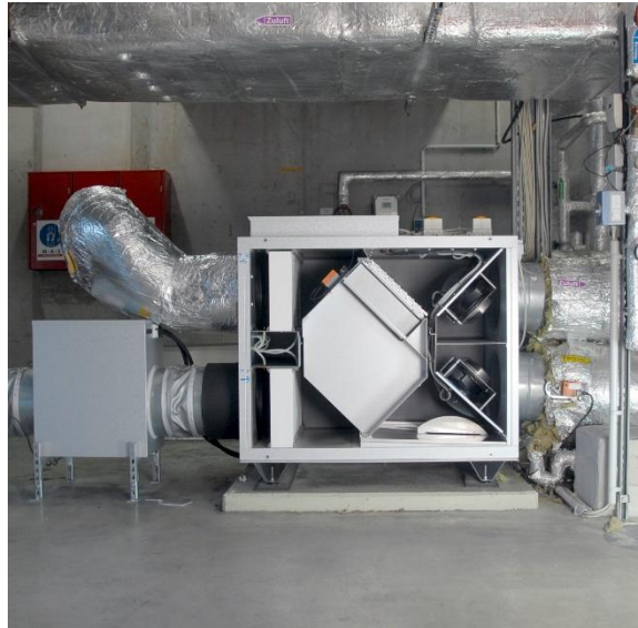
Lüftungsanlage Ludwig-Börne-Schule Foto: ABI, Abteilung Energiemanagement
