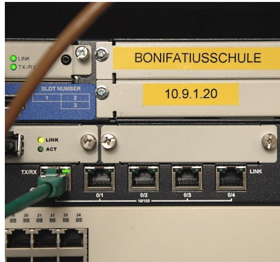
Netzwerkschrank Bonifatiuschule Foto: ABI, Abteilung Energiemanagement
