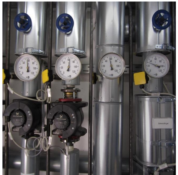
Überhöhte Vorlauf- und Rücklauftemperaturen Foto: ABI, Abteilung Energiemanagement
