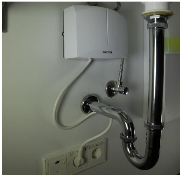
Klein-Durchlauferhitzer Foto: ABI, Abteilung Energiemanagement
