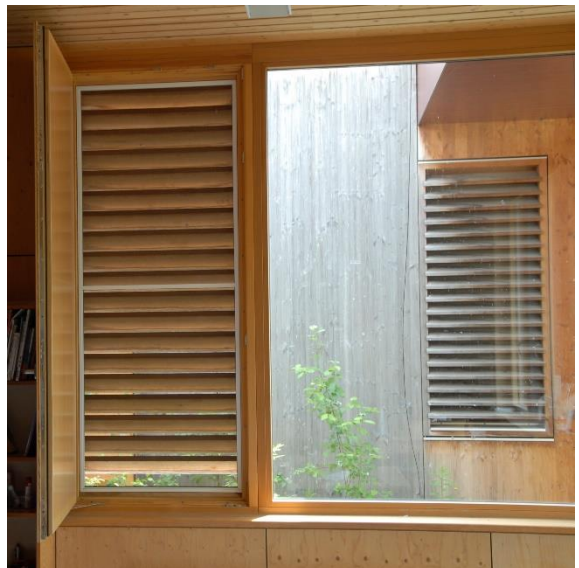
Nachtlüftungsöffnung Albert-Schweitzer-Schule, Foto: ABI, Abteilung Energiemanagement
