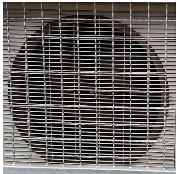
Kondensator Bürogebäude Gerbermühlstraße 48 Foto: ABI, Abteilung Energiemanagement
