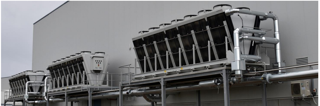
Lufttechnische Anlage © Stadt Frankfurt am Main, Umweltamt
