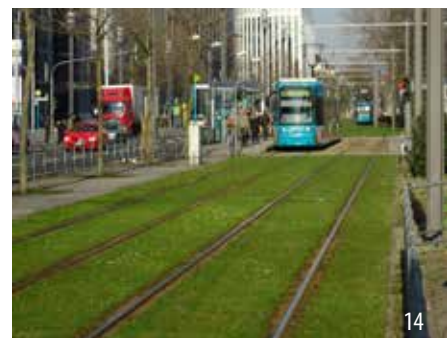
Begrünte Gleisanlagen zur innerstädtischen Kaltluftförderung
