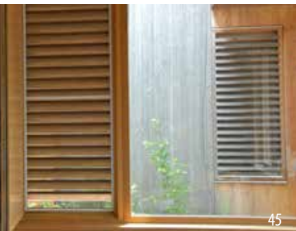
Nachtluftklappe im Schulgebäude
