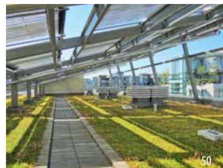
Solarthermie effektiv kombiniert mit extensiver Dachbegrünung
