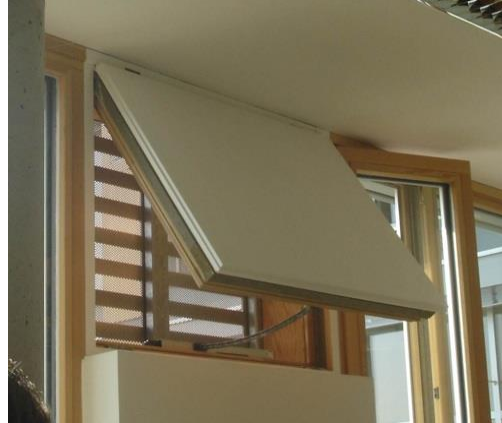
Abb. 5: Nachtluftklappe (Quelle: Hochbauamt FFM)
