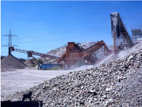
Ablagerung von Bauschutt und Erdaushub
