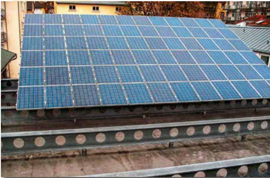
Oben: Photovoltaikanlage auf dem Flachdach der neuen Hans-Grötsch-Halle
