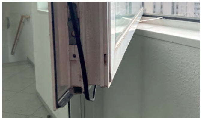
Defekte Fensterdichtung; © Gesundheitsamt
