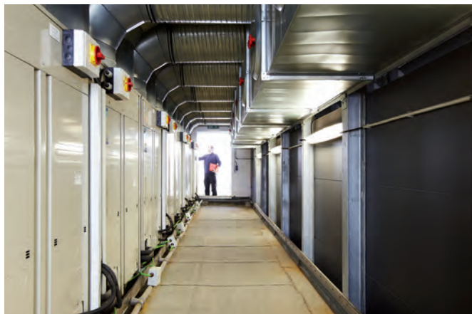
Technikzentrale Bauteil G, Kurt-Schumacher-Straße 8
