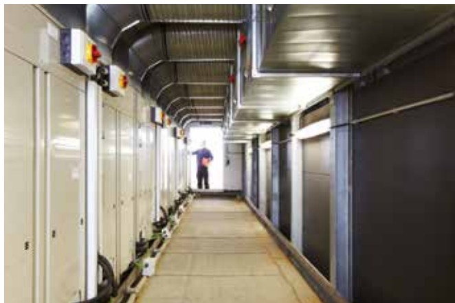
Technikzentrale Bauteil G, Kurt-Schumacher-Straße 8
