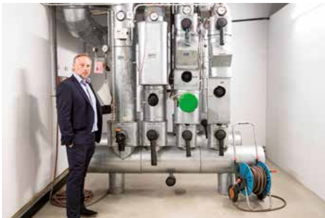
Herr Hage vor dem Kaltwasserverteiler, der bisher die Lüftungsanlagen der IHK versorgt (Foto: Salome Roessler Lens and Light)
