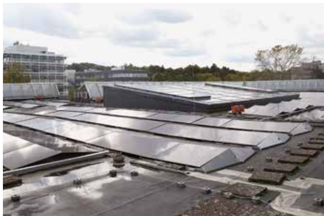
PV-Anlage auf dem Dach der Mensa Lichtwiese
