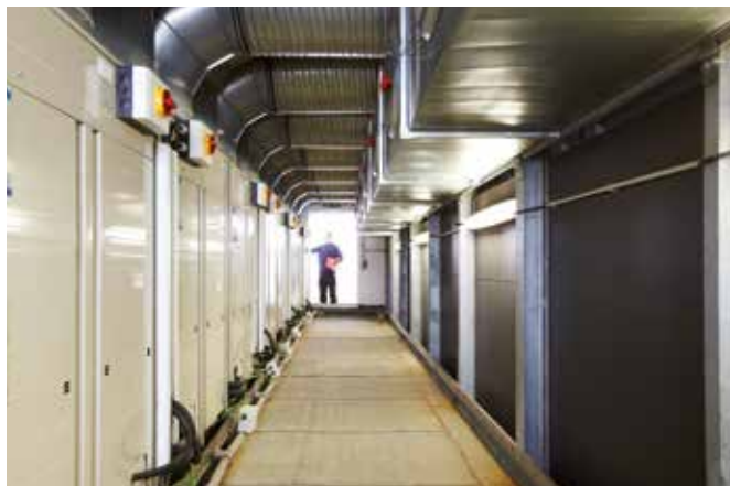
Technikzentrale Bauteil G Kurt-Schumacher-Straße 8
