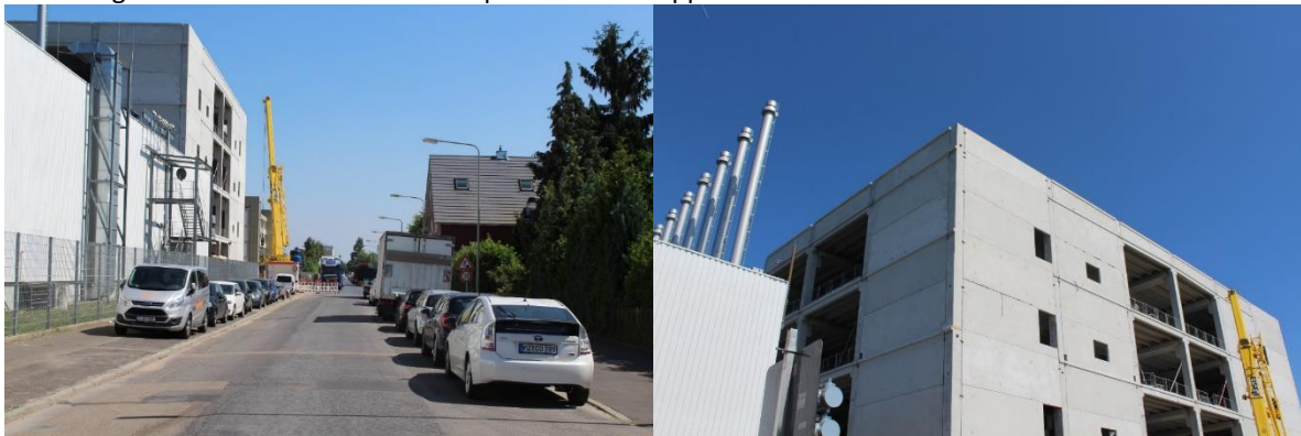
Abbildung 27: Erweiterung der Fa. Equinix in der Friesstraße
