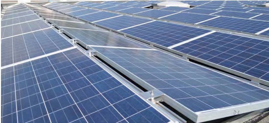
Abb. 19: Flach geneigte PV-Module in Ost-West-Richtung. Quelle: http://www.wohnen-mit-energie.de/photovoltaik/anlagenbeispiele-photovoltaik-anlagen/ )
