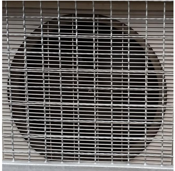
Kondensator Bürogebäude Gerbermühlstraße 48 Foto: ABI, Abteilung Energiemanagement
