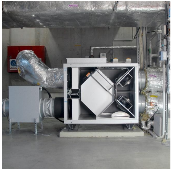
Lüftungsanlage Ludwig-Börne-Schule Foto: ABI, Abteilung Energiemanagement
