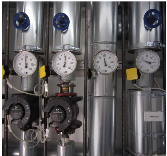
Überhöhte Vorlauf- und Rücklauftemperaturen Foto: ABI, Abteilung Energiemanagement
