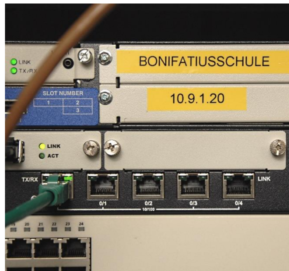
Netzwerkschrank Bonifatiuschule Foto: ABI, Abteilung Energiemanagement
